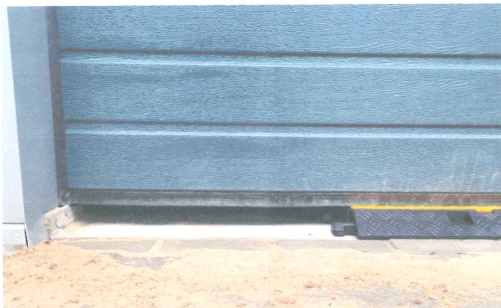
Fot. 3 Wycięta belka podwalinowa z widocznym obniżeniem pozadzki
